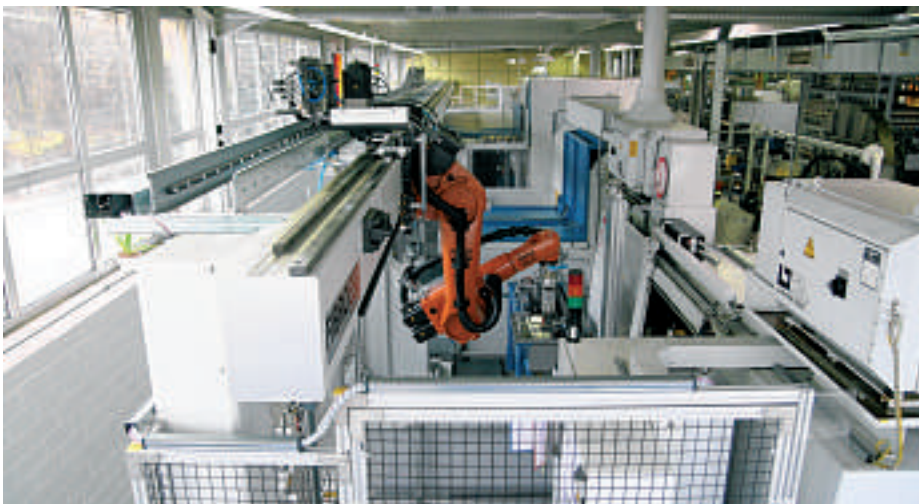
Fertigungslinie mit Gelenkarm-Portalroboter GL 60 von Fibro-GSA Automation und über 70 m Schutzzaun Quick-Guard E von Jokab Safety
