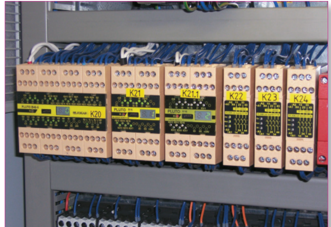
Bild 4: Die Sicherheits-SPSen Pluto B46-6 sowie Pluto B16 mit nachgeschalteten Erweiterungsrelais BT51 sind staubgeschützt im Schaltschrank untergebracht und überwachen die Sicherheit sämtlicher Anlagen.
