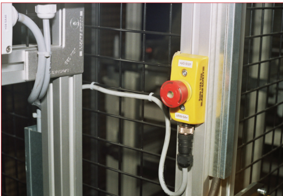
Die mittigen Befestigungslöcher des Not-HALT-Tasters Smile mit eingebaute Tina-Schnittstelle erleichtern den Einbau an den Aluminiumprofilen des Schutzzauns Quick Guard für ein Linienportal. (Foto Jokab Safety) [BLEICH 14]
